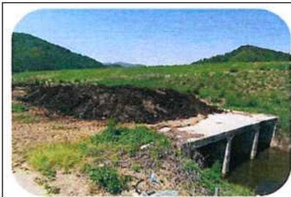
하천 주변 장소 야적 비가림시설 미설치
